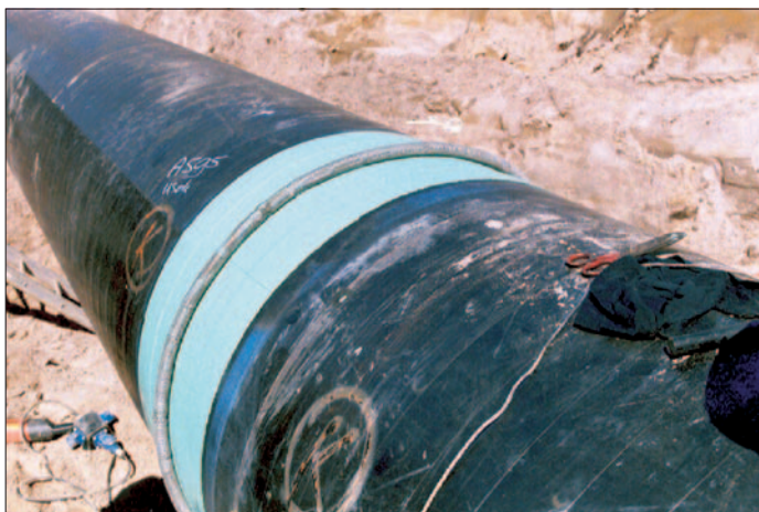
Bild 3: Nicht normungs- und regelwerkskonformer Einsatz von Nachumhüllungsmaterialien: Weichplastisches („viskoelastisches“) Korrosionsschutzband als Schweißnahtumhüllung Fig. 3: Use of field coatings contrary to material standards and technical rules – smooth („viscoelastic“) corrosion protection tape as field joint coating
